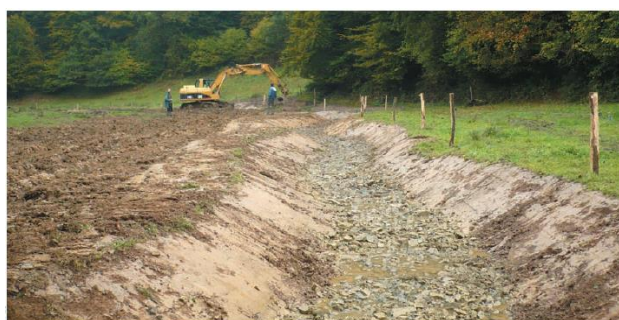
La phase de travaux de la restauration de la Doquette en octobre 2008 : reconstitution du matelas alluvial du cours d'eau par l'apport de matériaux.
