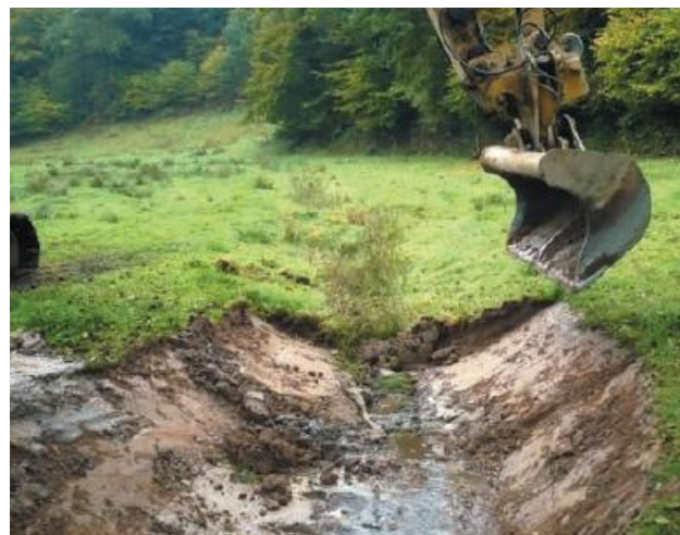
La phase de travaux de la restauration de la Doquette en octobre.
