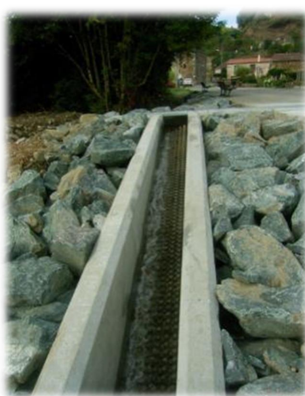
Aménagement d'une rampe à anguilles sur le Petit Lay à Mouchamps (source : SCE, 2010).
