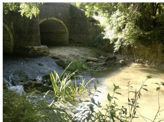
Radier de pont infranchissable
