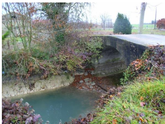
Surcreusement du lit et radier de pont infranchissable
